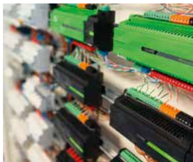
Loxone Automationssystem im geöffnetem Schaltschrank
