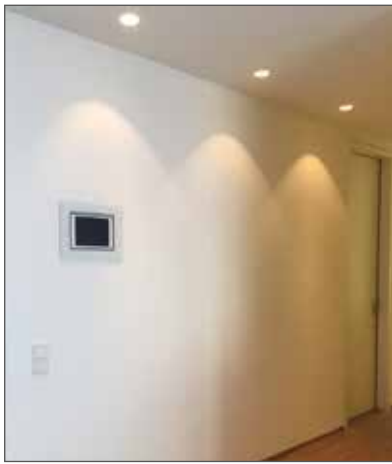
Beleuchtung mit LED-Technik durch Präsenzmelder aktiviert (Lichtszenen sind möglich)
