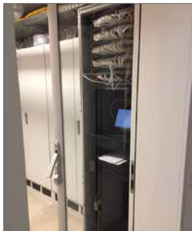
Blick in den Schaltschrank
